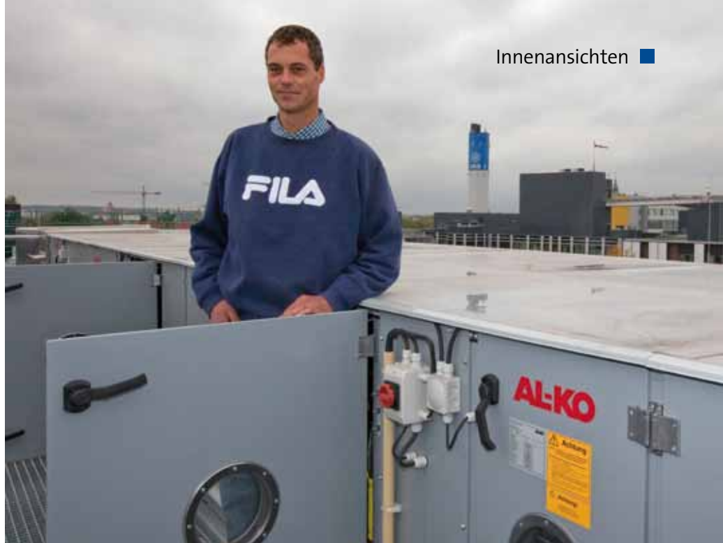
Arbeiten in luftiger Höhe: Techniker Frank Kühlsen an den Steuerungselementen der neuen Lüftungsanlage, die auf dem Dach des Onkologischen Zentrums installiert wurde
